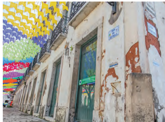
Prédio em ruínas na Praia Grande
